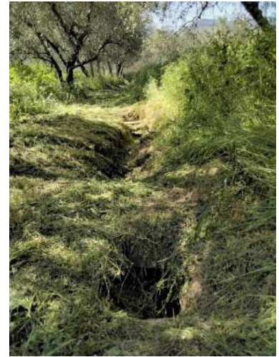
Tratti di frana della copertura
